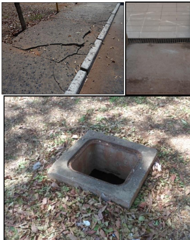
Figuras 64, 65 e 66: calçadas danificadas, grelhas no acesso aos prédios, e caixas de inspeção sem tampas na 408 Norte.
