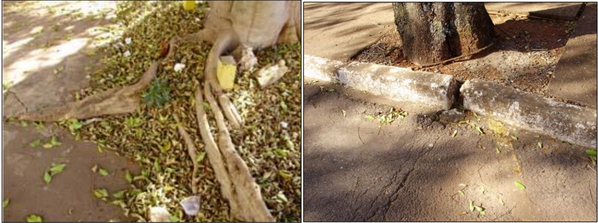
Figuras 73 e 74: Calçada e via danificadas pelo sistema radicular na 408 Norte. Fonte: Foto da autora.
