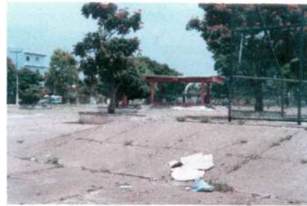
Coreto próximo a quadra de esporte na praça em mau estado de conservação
