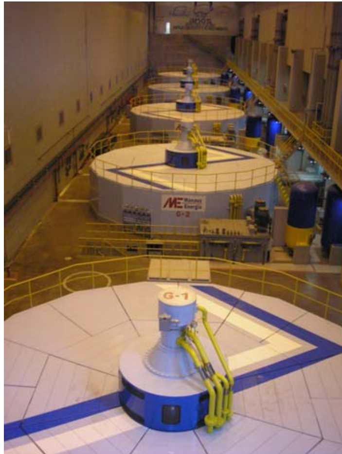
Figura 7.2- Vista superior dos 5 geradores.
