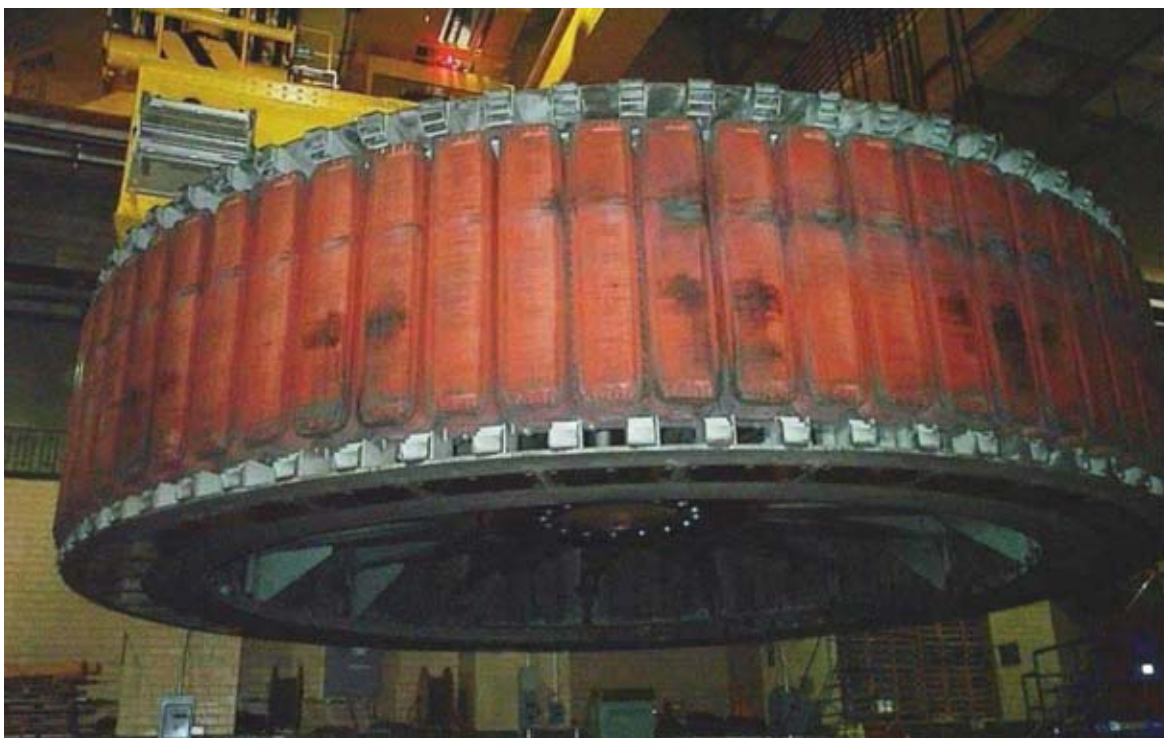
Figura 7.3- Rotor do gerador elétrico.
