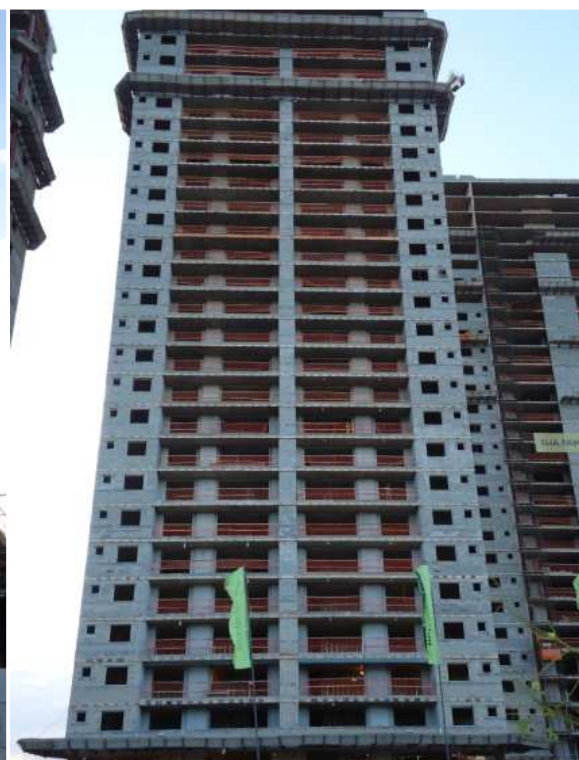
Figura 2.3.9 - Obra de 24 pavimentos em águas Claras-DF utilizando sistema estrutural com laje lisa
