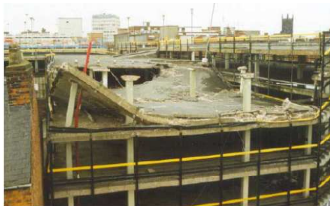
Figura 2.3.5 - Colapso da 4a laje do edifício Pipers Row Car Park, Wolverhampton-Inglaterra (WOOD, 1997)
