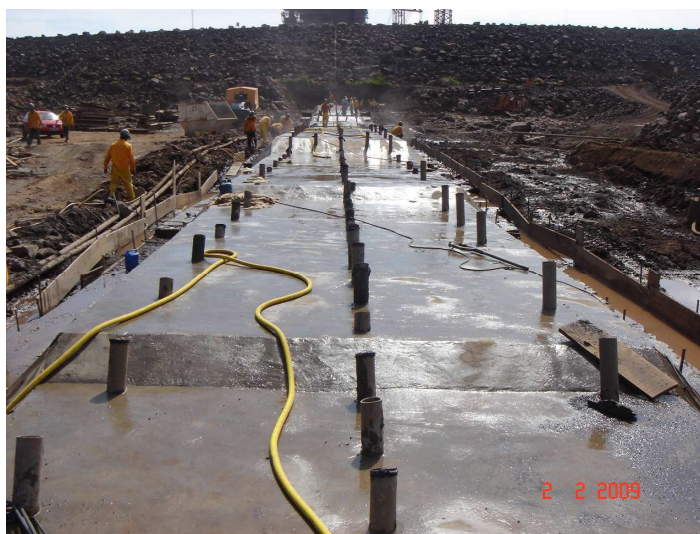
Figura 3.24 Detalhe dos Degraus de Acerto do Plinto e Tubos de Espera das Injeções.
