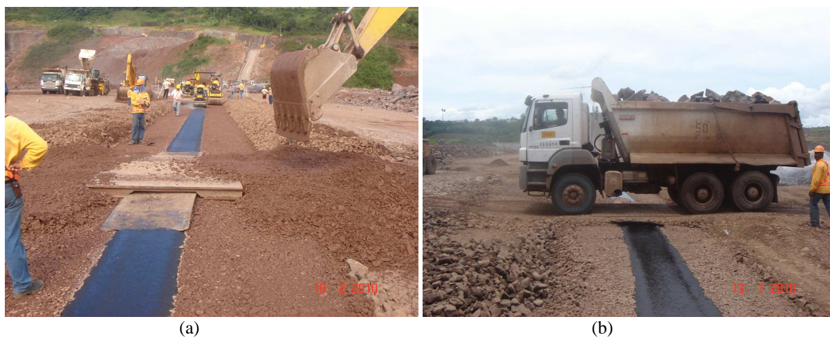
Figura 3.36 Ponte Metálica: a) Detalhe da Instalação da Ponte, b) Trânsito de Caminhão Sobre o Núcleo.
