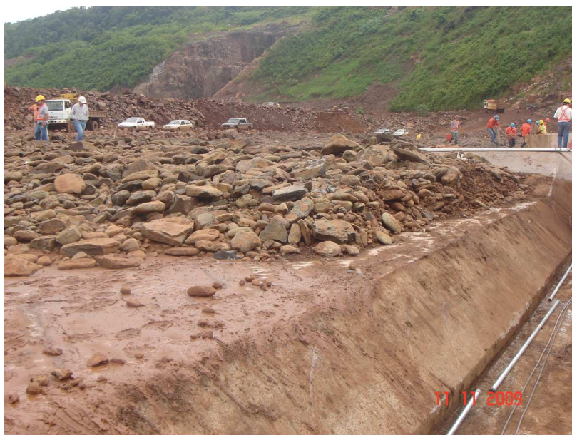
Figura 3.25 Material Depositado sobre o Plinto Durante o Período de Desvio do Rio.
