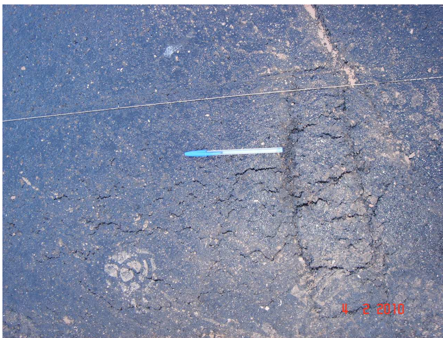
Figura 3.47 Trincas no Topo da Camada.
