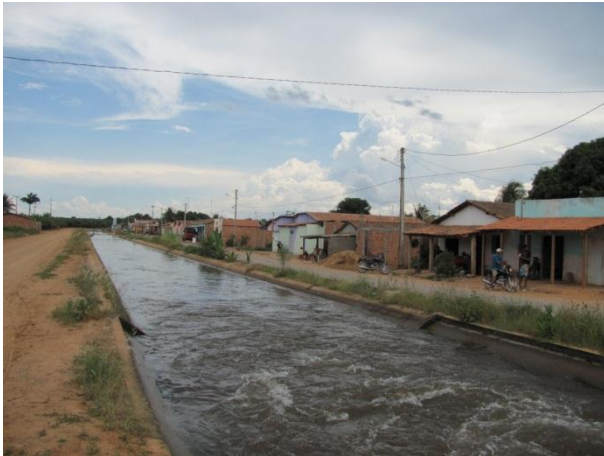
Canal de distribuição próximo à Vila do 33 – Projeto Formoso
