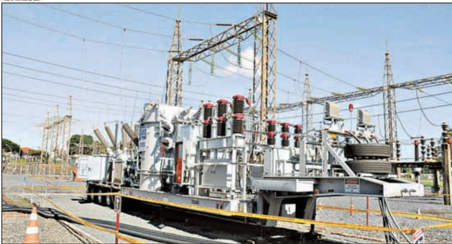
Subestação móvel começou a ser testada em Taguatinga, onde a sobrecarga no fornecimento de energia chega a 28% nos horários de pico
