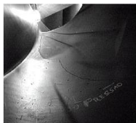
Figura 1.1. Trinca em pá de turbina hidrogeradora fabricada em aço ASTM A 743.
