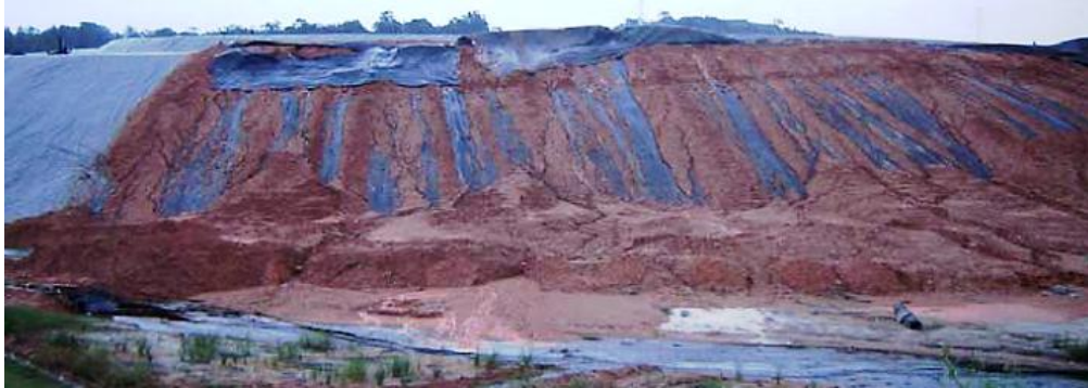
Figura 2.25 Falha do sistema original de cobertura mostrando a geomembrana exposta (Abramento et al. , 2008).
