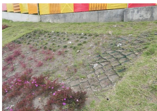
Figura 4.57 Erosão do talude onde houve perda de sementes antes da germinação devido a falta de geomanta.
