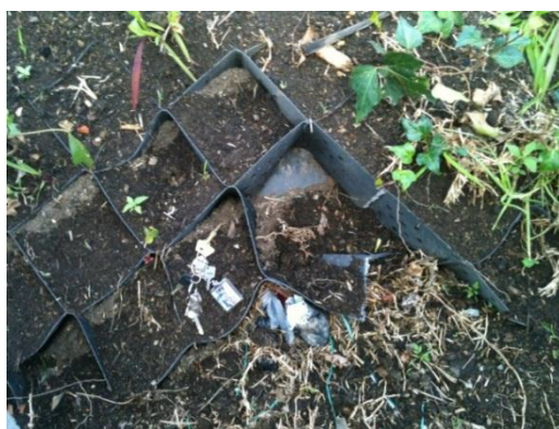
Figura 4.61 Exposição da geocélula e rompimento da mesma ocasionando a exposição da geomembrana.
