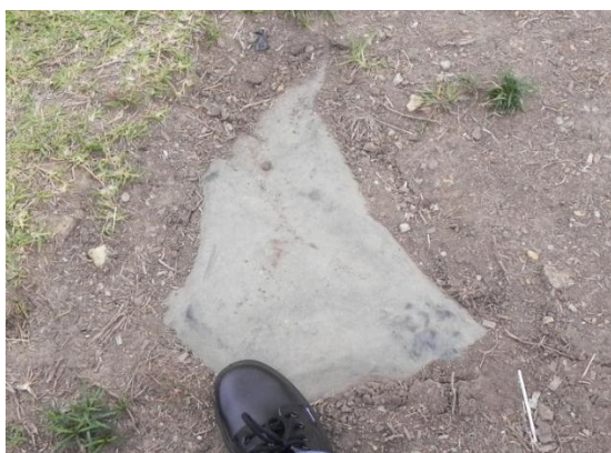
Figura 4.58 Formação de bolha sob a geomembrana.
