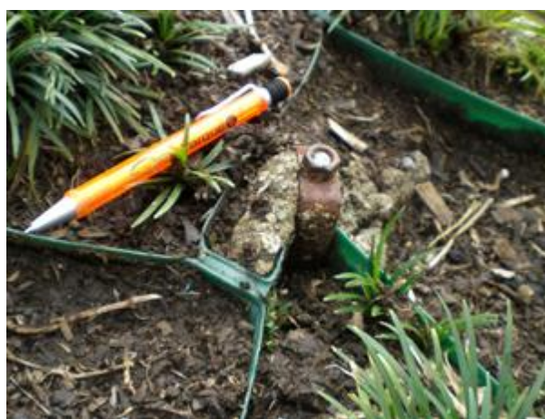
Figura 4.59 Corrosão aparente do grampo de fixação da geocélula.
