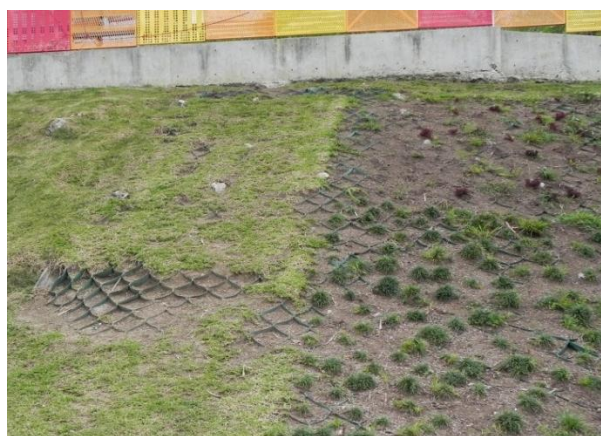
Figura 4.56 Erosão do talude à altas inclinações com a exposição da geocélula.
