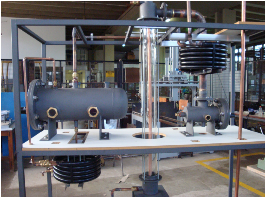
Figura 4.15. Absorvedor, TC_{sol} e condensador em sua posição definitiva na bancada.
