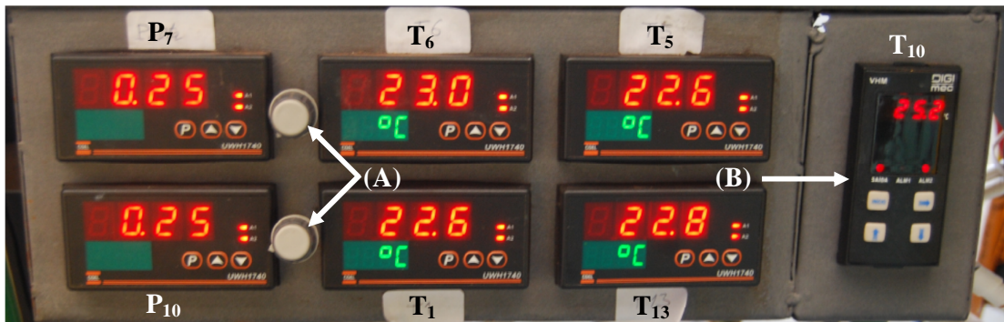
Figura 4.18. Detalhe do painel de comando.
