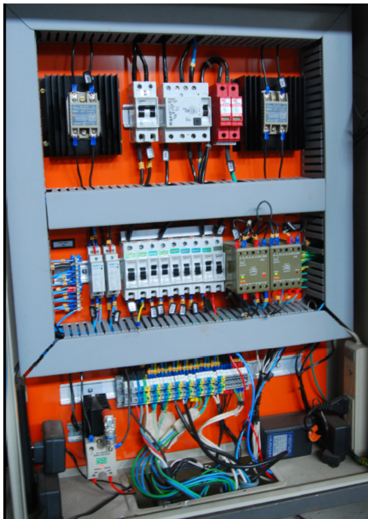
Figura 4.20. Detalhe interno do quadro elétrico de força.
