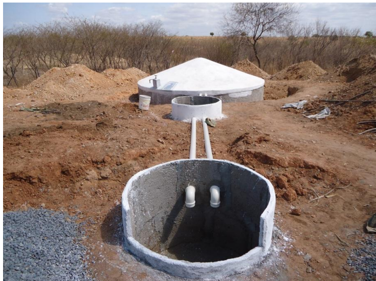
Tanques de contenção com cisterna ao fundo
