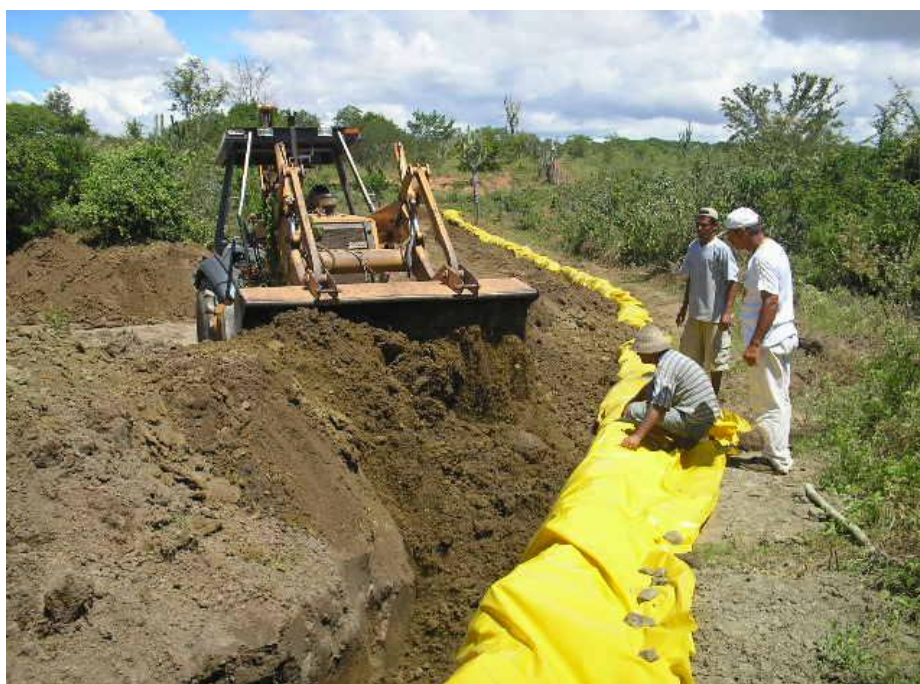
Preenchimento da vala para formação do muro de contenção Foto Arquivo ASACom
