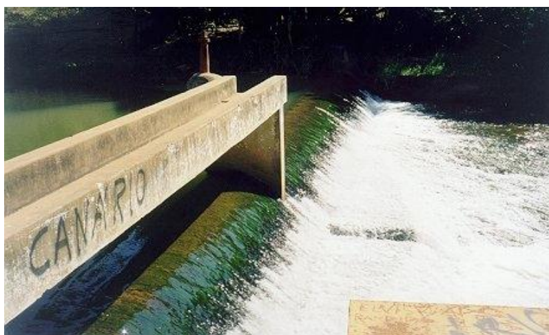
Figura 4.5: Barragem para manutenção do nível mínimo, com vertedor "Creager" e passarela de acesso ao dispositivo de descarga (Projeto Preparatório para o Gerenciamento dos Recursos Hídricos do Paraíba do Sul 13 ).
