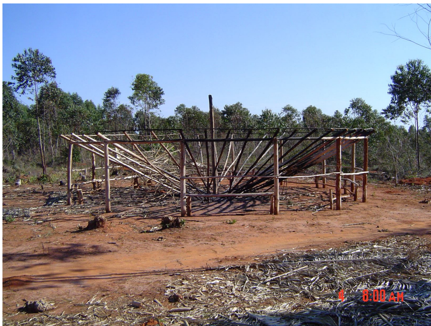
Fotografia 12 – Caramanchão da comunidade de Vereda Funda destruído. Fonte: CAA-NM.
