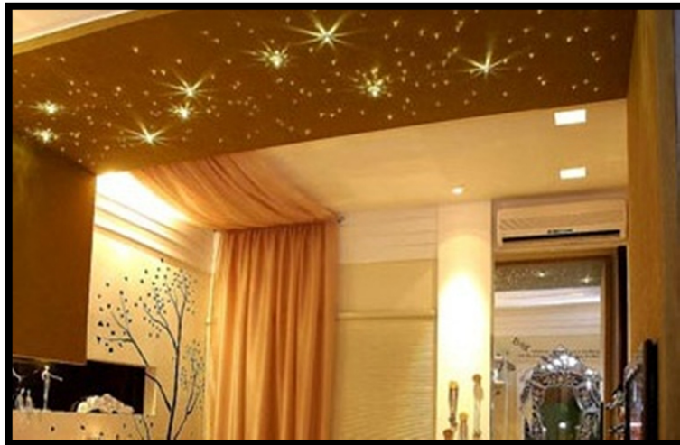
Figura 13: Iluminação tipo pontual com fibra ótica.
