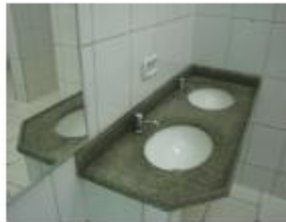
Duas torneiras que substituíram as antigas em banheiro masculino do bloco já existente.
