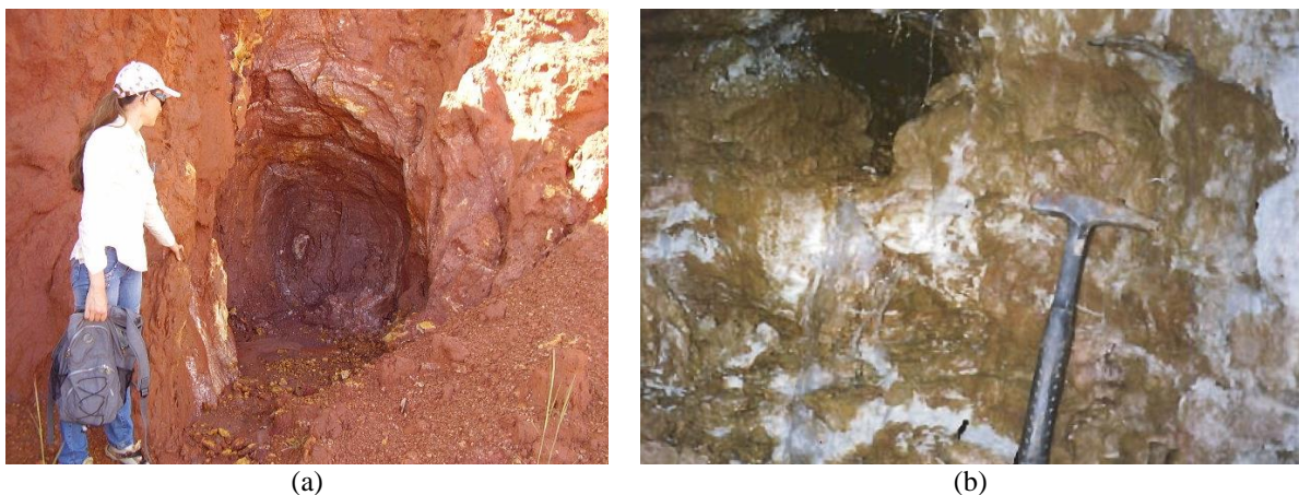
Figura 2.4 - Ocorrências de piping : (a) Associado à infiltração concentrada a montante em Anápolis-GO; (b) Em talude de voçoroca em Goiânia, GO (Santos, 1997).
