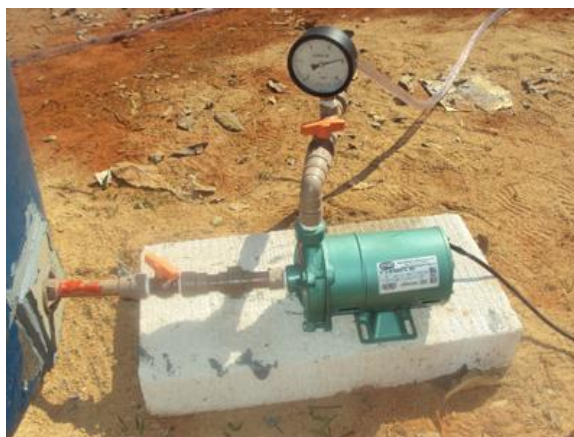
Figura C13 – Sistema de controle da intensidade de chuva (bomba, manômetro e registros)
