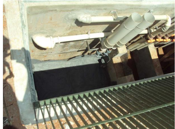
Figura 4.25 – Tubulação de monitoramento
