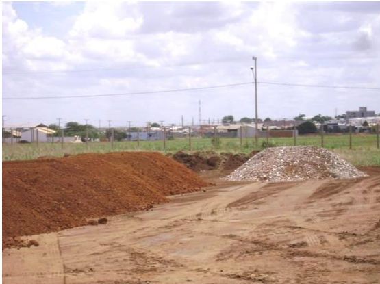
Figura 5.10 - Detalhe das pilhas de solo e RCD utilizados na camada de base.
