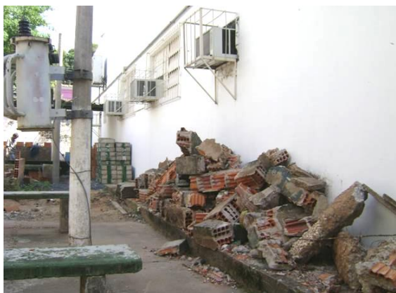
Figura 3.5 - Resíduos de alvenarias oriundos de paredes internas do IFMT.
