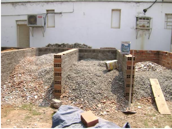
Figura 5.4 - RCD acondicionado em baias.
