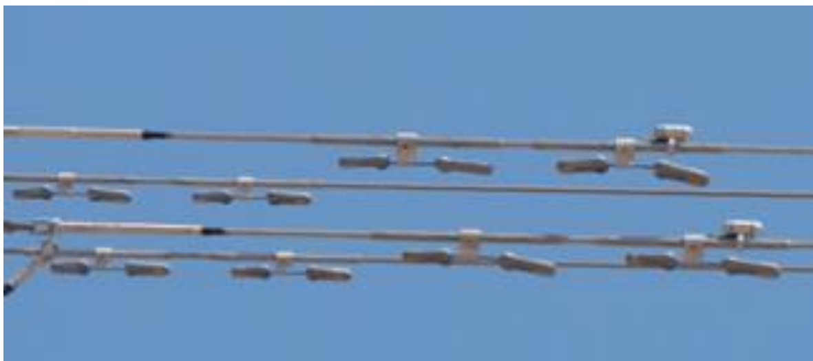
Figura 21 – Foto com detalhe do sistema de amortecimento mostrando a presença de mais de um amortecedor próximo a uma torre de ancoragem
