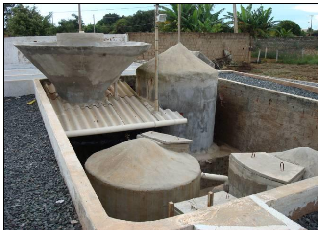
Figura 4. 8 - Estrutura de tratamento de efluentes da empresa charqueadora
