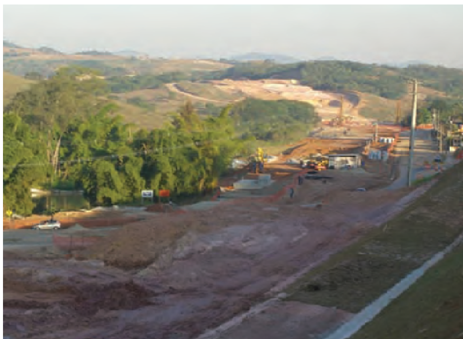
Figura 4.2. Vista da zona de construção da via, São José dos Campos (Huesker, 2000).
