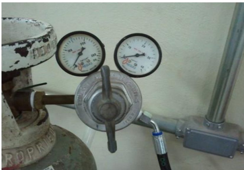
Figura 54 - Válvula redutora do cilindro de nitrogênio
