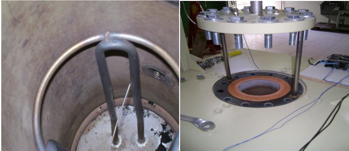
Figura 38 - Reator antes do novo isolamento
