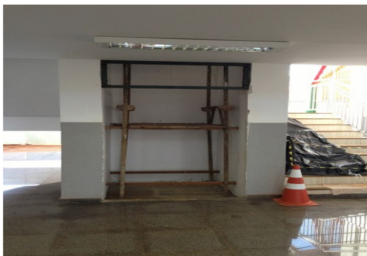
Fotografia 04: ausência de rampas e pendência na instalação do elevador câmpus Samambaia
