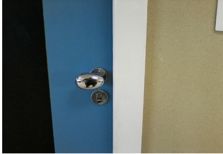
Fotografias 06 e 07- maçanetas câmpus Brasília, bloco sala de aulas.
