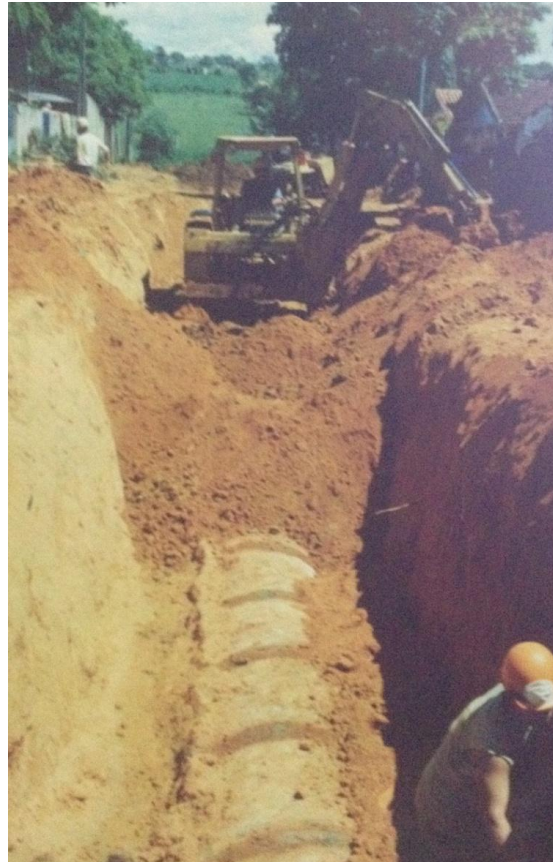
FIGURA 25 – Abertura de vala para implantação do esgoto pluvial In: Geralda Santa Bárbara - Associação de Moradores (1993)
