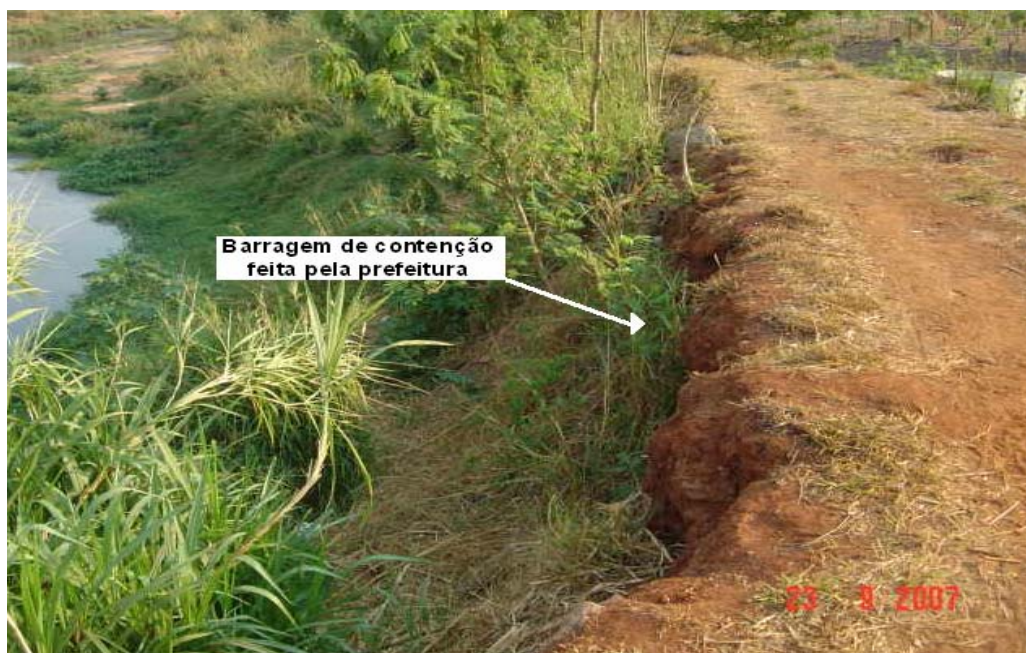
Foto 02: Paredão para a contenção da água do rio construído pela prefeitura.
