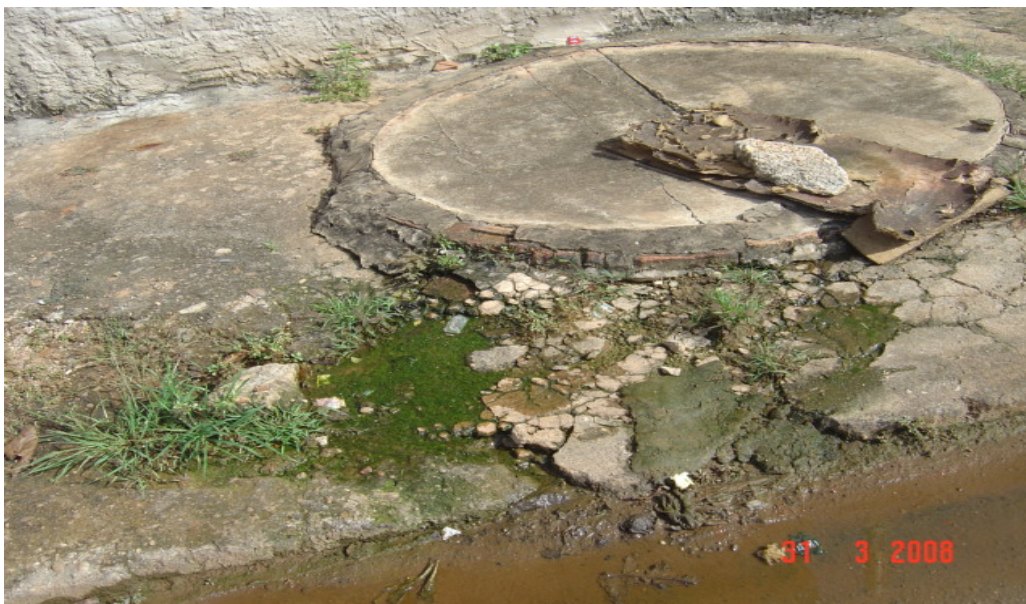
Foto 07: Fossa séptica situada na calçada apresentando vazamento
