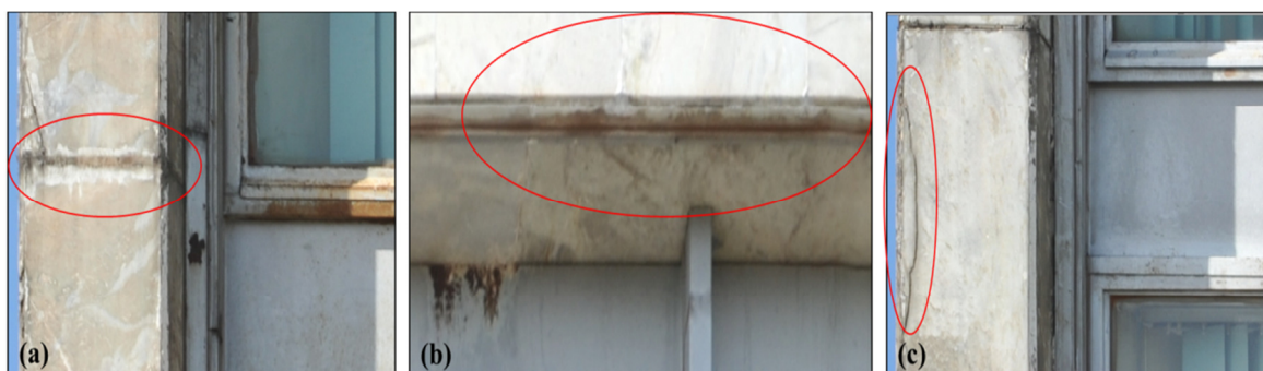
Figura 5. 45 – (a) placas com manchas acastanhadas e manchas escuras na junta de dilatação; (b) placas contaminadas pela eflorescência e (c) Placa com fissuras
