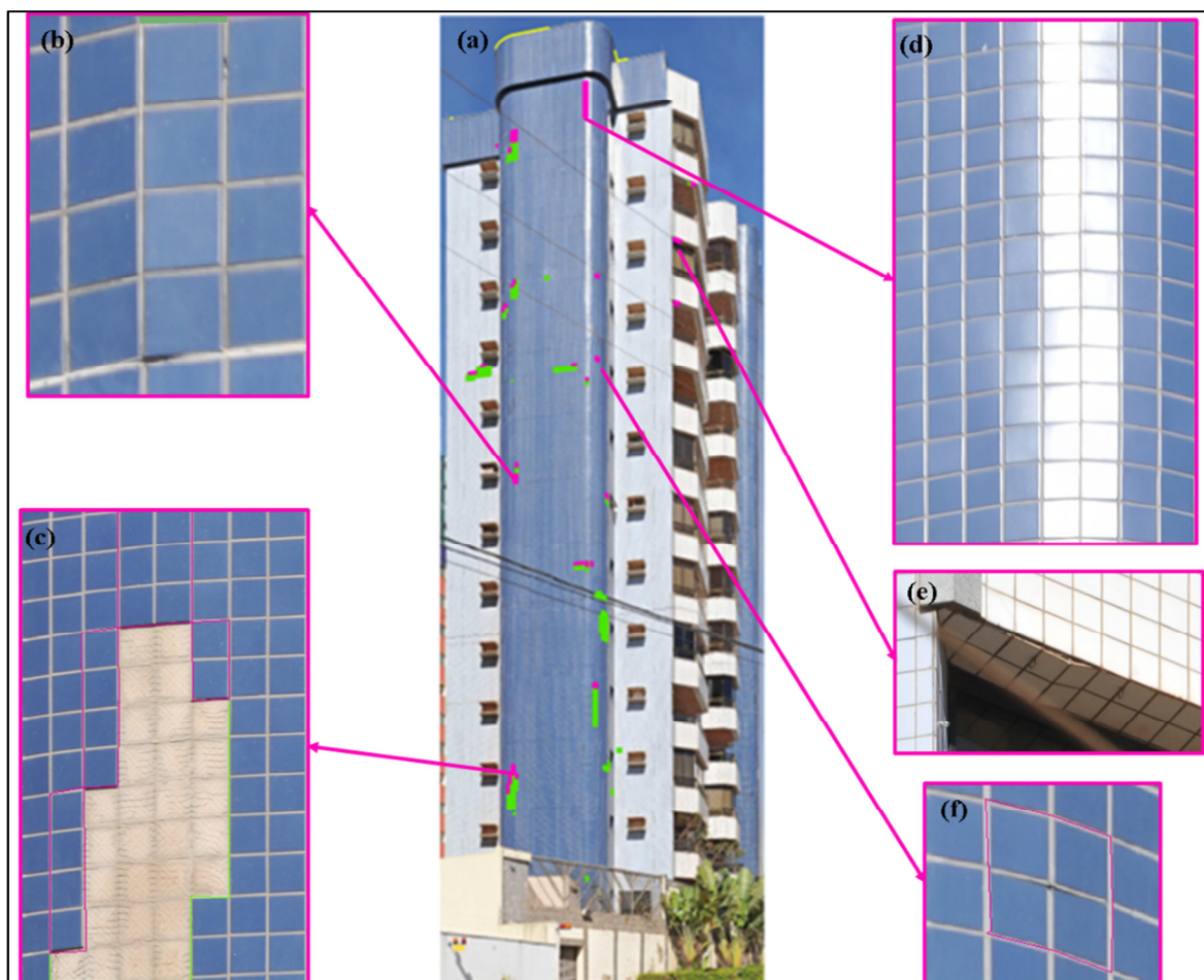
Figura 5. 23 – Fachada B (Nordeste) do edifício residencial: (a) imagem da posição frontal; (b, d, e, f) descolamento cerâmico e (c) deslocamento cerâmico
