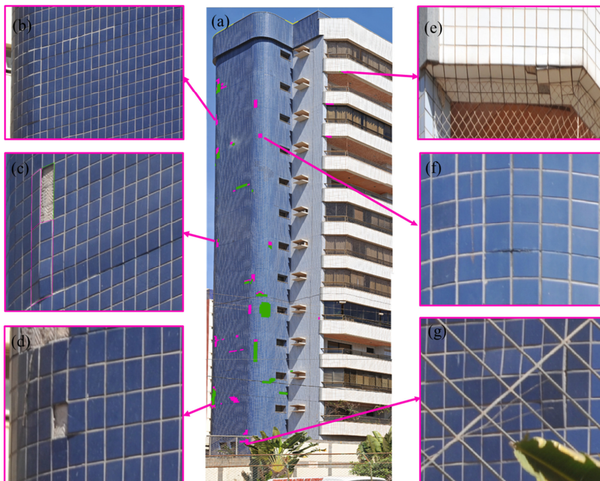
Figura 5. 24 – Fachada B (Nordeste) do edifício residencial: (a) imagem da posição lateral (b, f, g) descolamento cerâmico e (c, d, e) descolamento e deslocamento cerâmico
