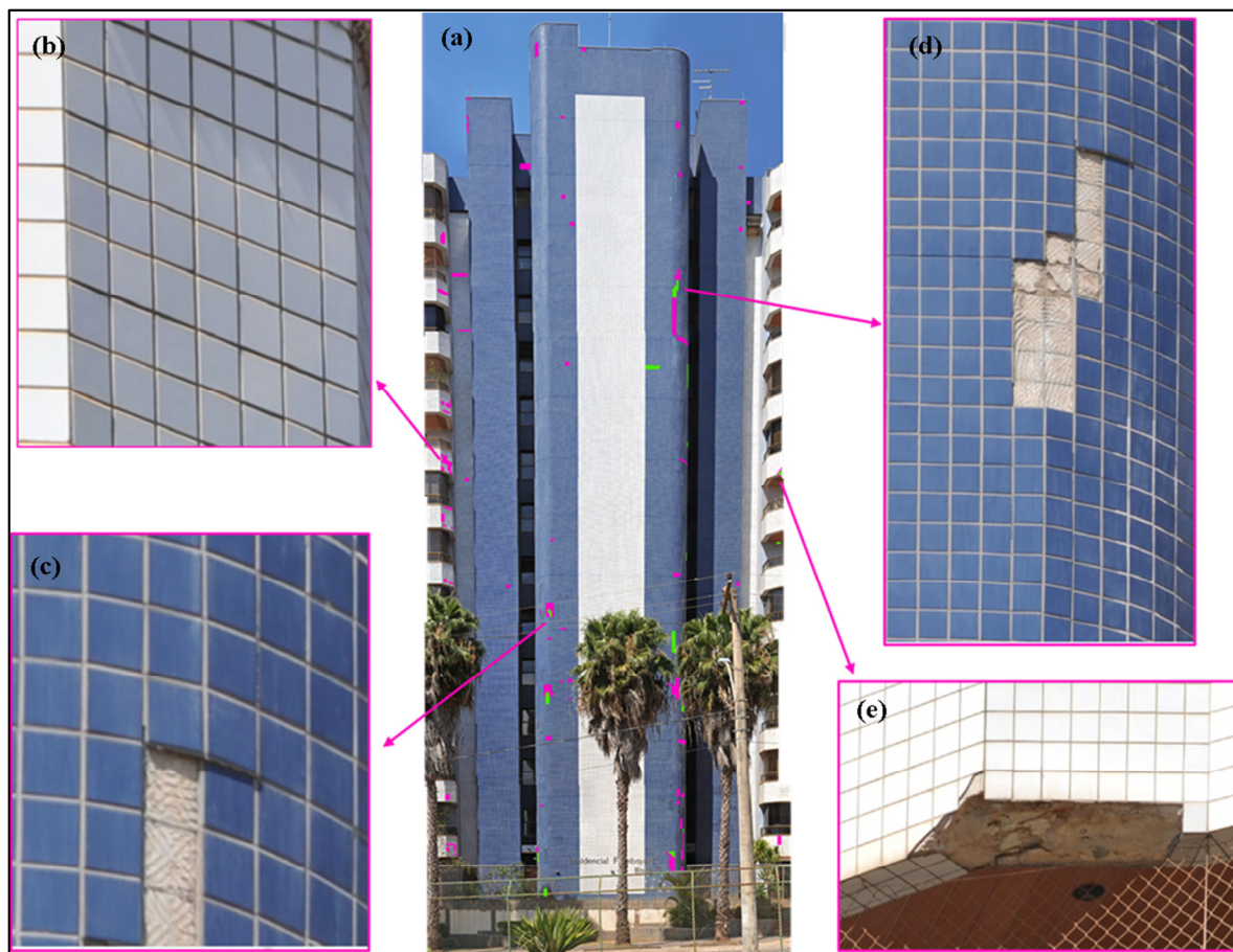
Figura 5. 19 – Fachada A (Noroeste) do edifício residencial: (a) imagem da posição frontal; (b) descolamento cerâmico; (c) e (d) descolamento e deslocamento cerâmicos e (e) deslocamento cerâmico com parte do substrato
