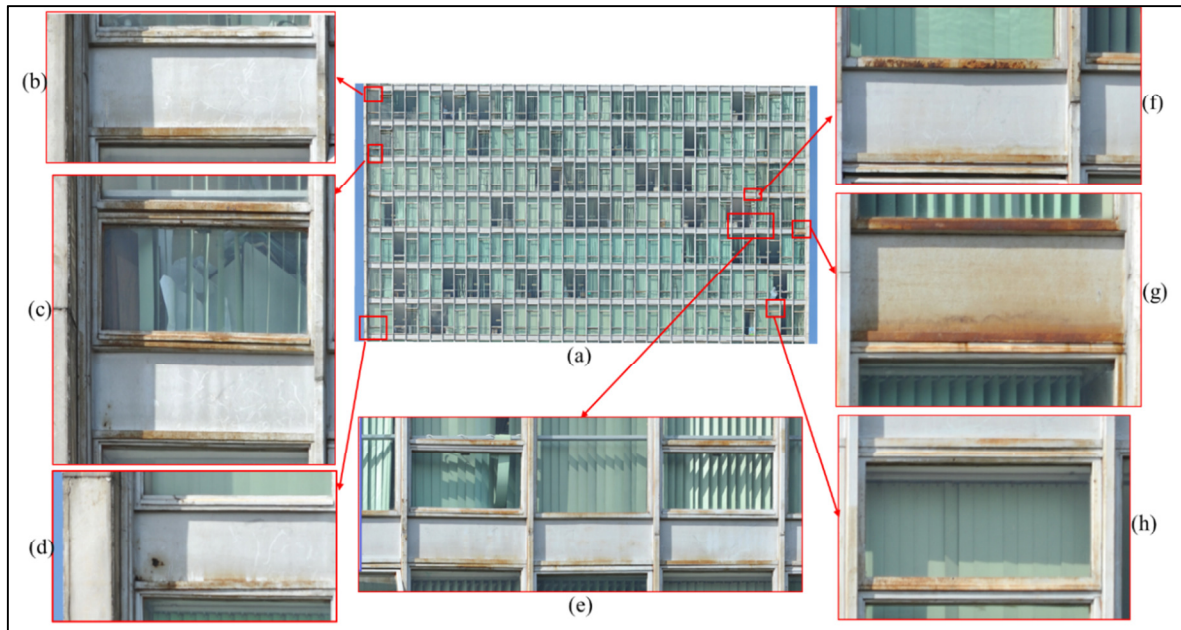
Figura 5. 39 – Etapa 2 (dois) da fachada Sul da torre do Anexo I da Câmara dos Deputados: (a) etapa 2 da fachada Sul; (b) e (c) corrosão visível no estágio inicial e placas de mármore com manchas; (d) corrosão visível no estágio inicial e no estágio avançado; (e) e (g) corrosão visível no estágio avançado e (h) corrosão visível no estágio inicial.
