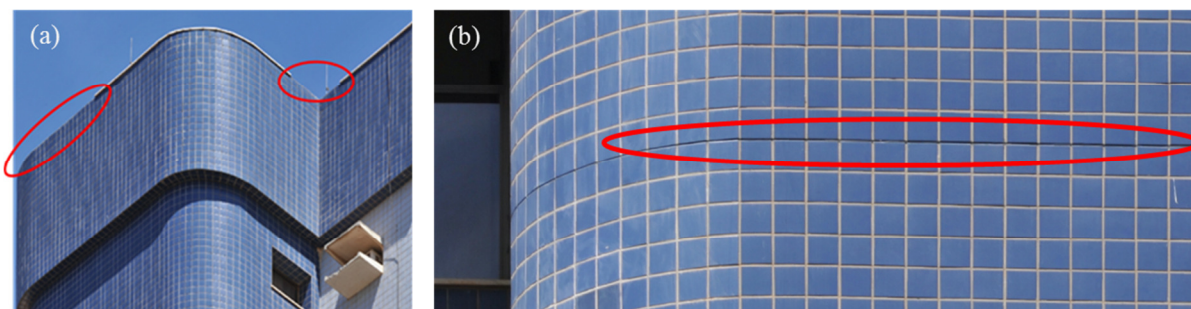
Figura 5. 25 – Fachada B (Nordeste): (a) falta de cimalha e pingadeira e (b) deficiência das juntas de dilatação
