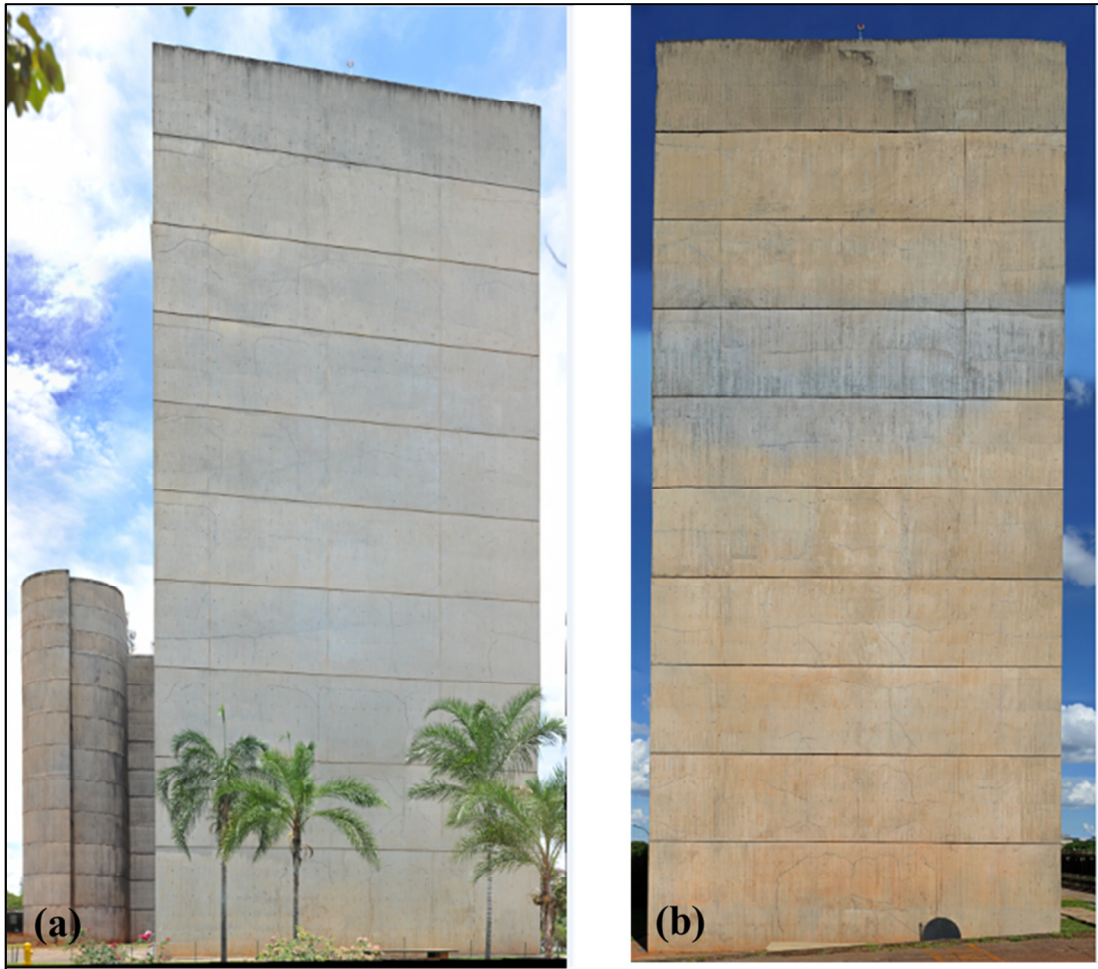
Figura 5. 62 – Imagens panorâmicas do edifício Anexo IV da Câmara dos Deputados: (a) Fachada Leste e (b) Fachada Oeste
