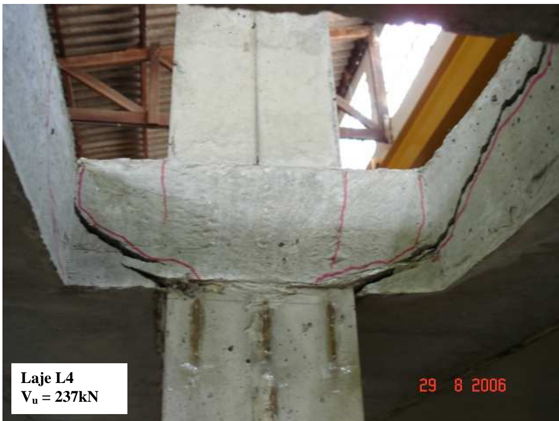
Figura 4.13 – Fotografia das superfícies de ruptura das lajes da Série 1 (continuação)
