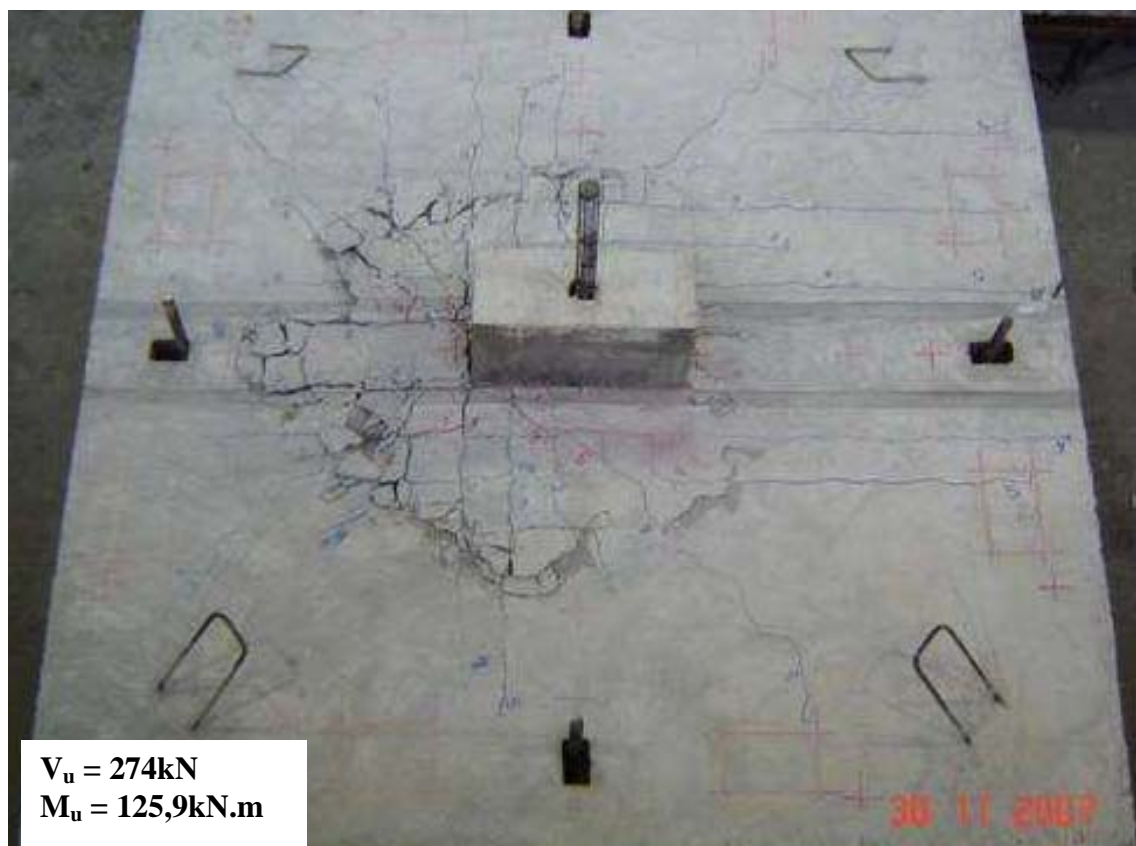
Figura 5.7 – Fissuração na laje L14
