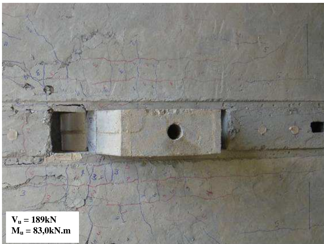
Figura 5.3 – Fissuração na laje L10
