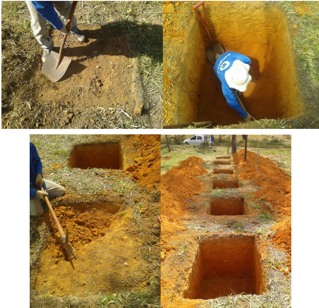
Figura 3.21 – Escavação das células em campo. (a) início da escavação; (b) célula sendo escavada; (c) abertura de novas células; (d) células já escavadas
