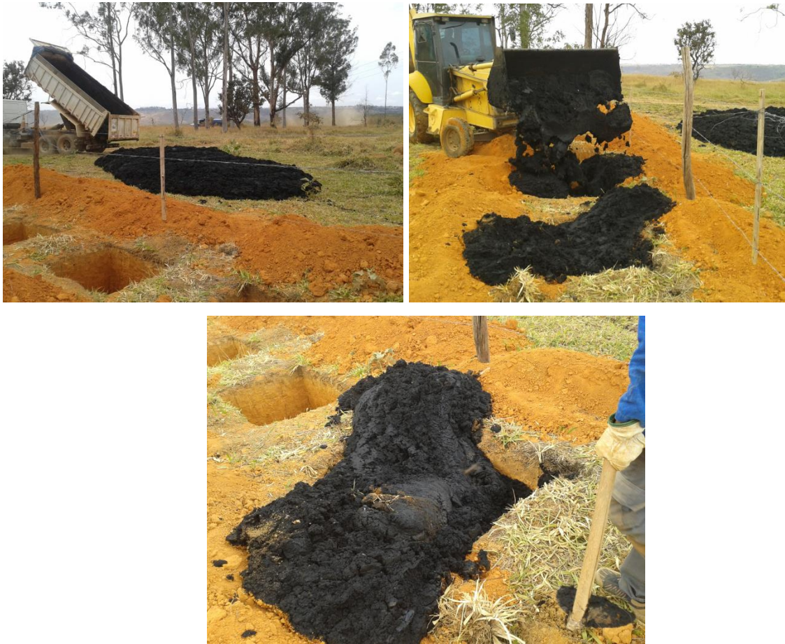
Figura 3.23 – Preenchimento das células com lodo de esgoto. (a) basculamento do lodo na área. (b) pá carregadeira preenchendo a célula com lodo; (c) célula preenchida com lodo de esgoto.
