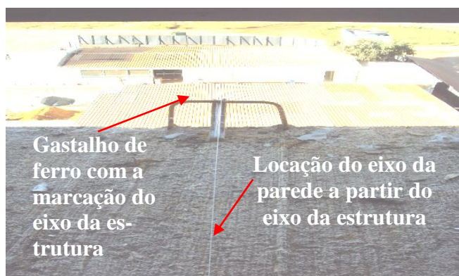
Figura 2.7 - Demarcação da posição da alvenaria a partir do eixo transversal da estrutura
