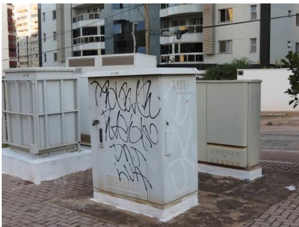
Figura 16 – Pichação em estruturas de iluminação
