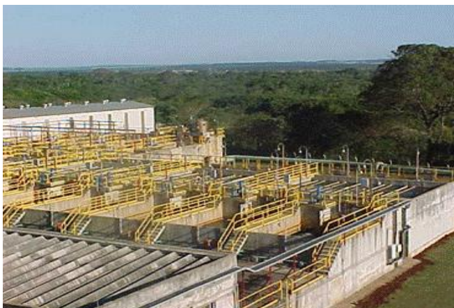
Figura 19 Planta de tratamento de água
