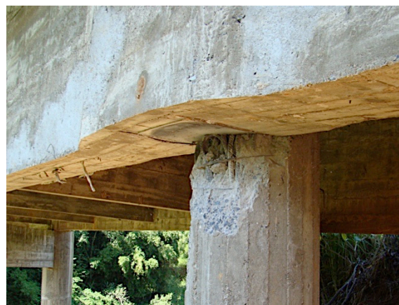
Figura 20: sinais de esmagamento do concreto ( F_i = 4 )
