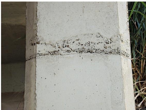
Figura 11: falha de concretagem ( F_i = 1 )
