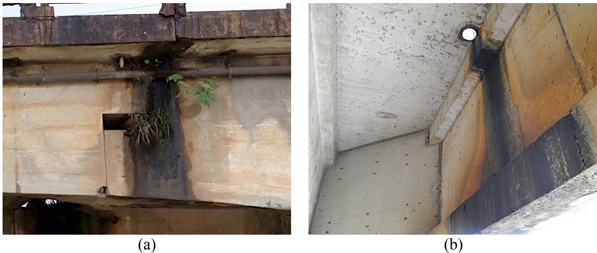
Figura 4.9 - Manchas no concreto: (a) junta de dilatação com selante danificado; (b) dreno descarregando água ao longo da altura da viga.
