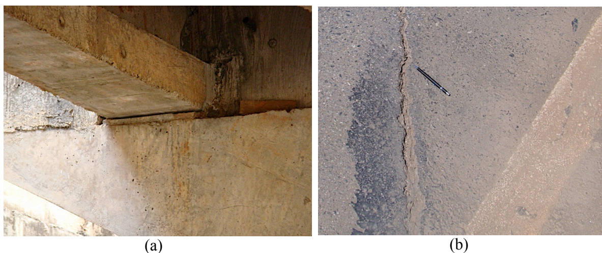
Figura 5.2 - Elementos encobertos: (a) aparelho de apoio coberto por concreto; (b) junta cobertas pelo pavimento.
