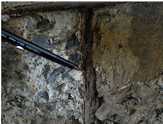
Figura 3: corrosão de armadura ( F_i = 4 )
