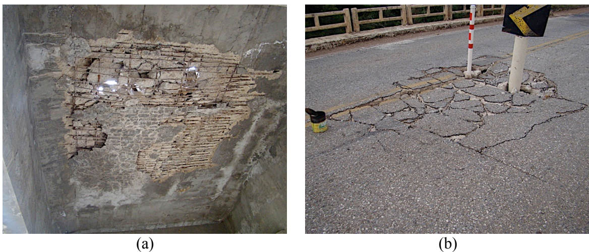
Figura 4.11 - Disgregação do concreto: (a) vista inferior da laje com partes íntegras do concreto soltas; (b) vista superior do local.
