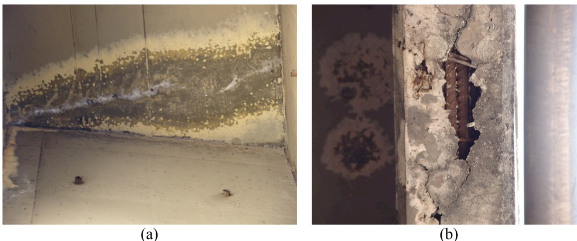
Figura 6.4 - Danos na laje e na viga da OAE-01. (a) Mancha, fissura e eflorescência na laje; (b) falha de concretagem deixando a armadura da viga sem cobertura.
