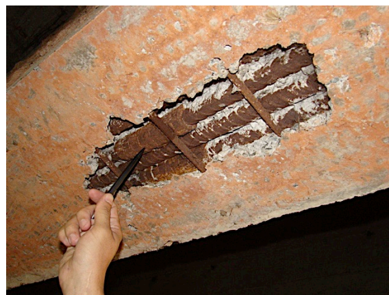
Figura 14: falha de concretagem ( F_i = 3 )
