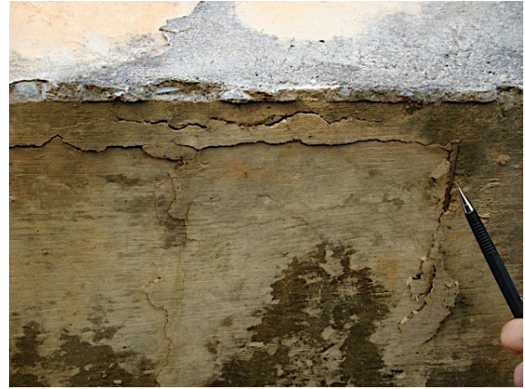
Figura 2: corrosão de armadura ( F_i = 3 )
