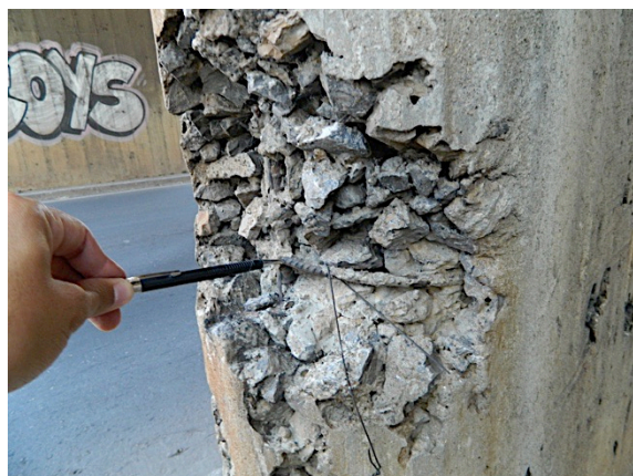
Figura 13: falha de concretagem ( F_i = 3 )
