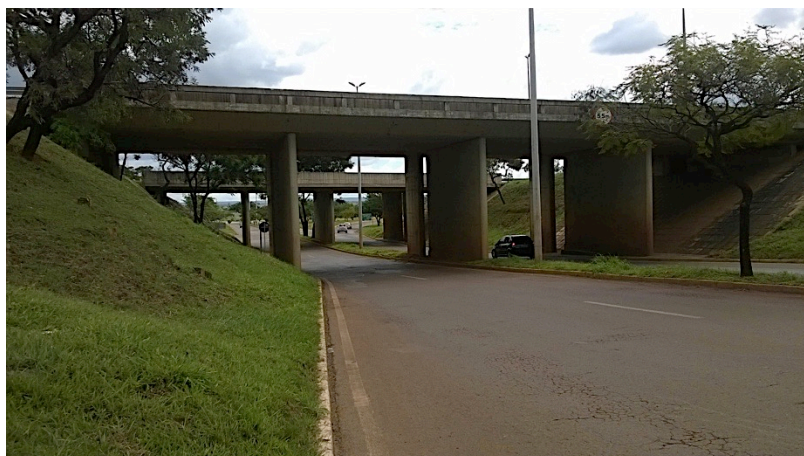
Figura 6.17 - Vista lateral da OAE-09, superestrutura em laje apoiada diretamente sobre pilares parede.
