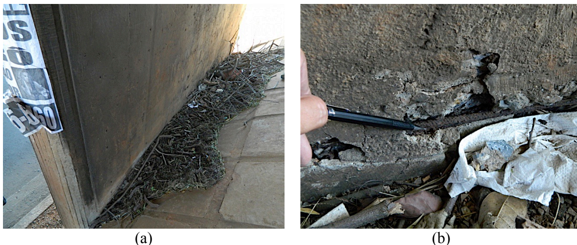
Figura 4.3 - Pilar de viaduto com: (a) acúmulo de galhos e terra na base do pilar, e (b) deslocamento do concreto causado pela corrosão da armadura.
