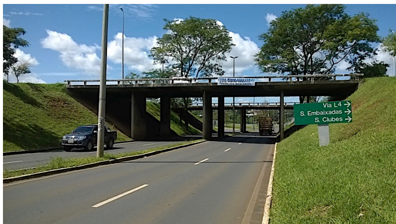
Figura 6.19 - Vista lateral da OAE-11, superestrutura em laje apoiada diretamente sobre pilares parede.
