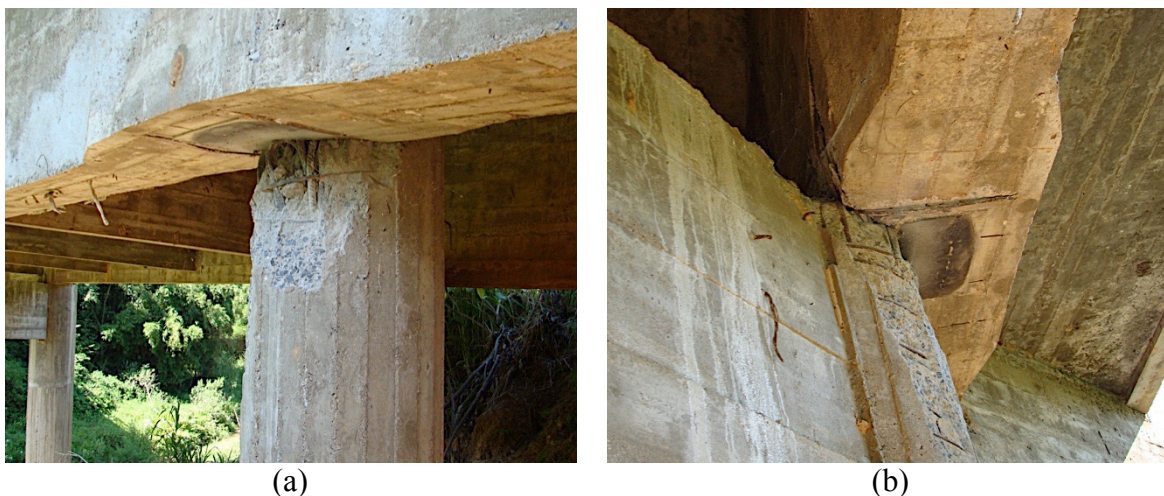
Figura 4.8 - Deslocamento da superestrutura em relação à mesoestrutura: (a) detalhe do topo do pilar rompido por concentração de tensões; (b) vista inferior do local mostrando o local original do aparelho de apoio.
