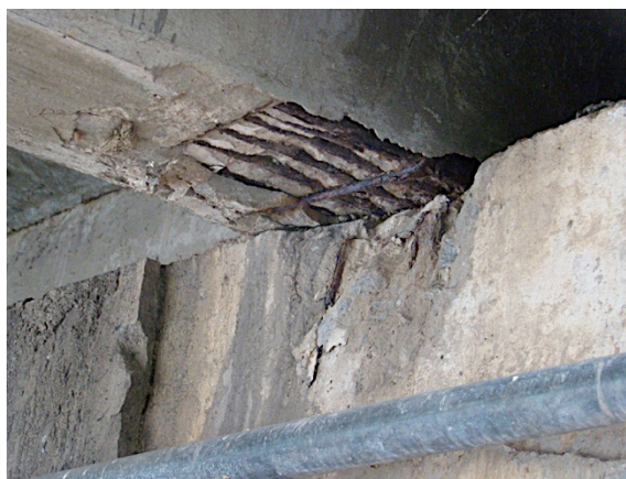
Figura 19: sinais de esmagamento do concreto ( F_i = 3 )
