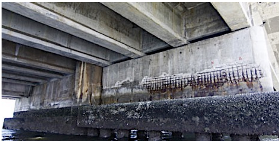
Figura 4.2 - Vista de um dos pilares da ponte, mostrando a deslocamento do concreto de cobrimento provocado pela corrosão da armadura.
