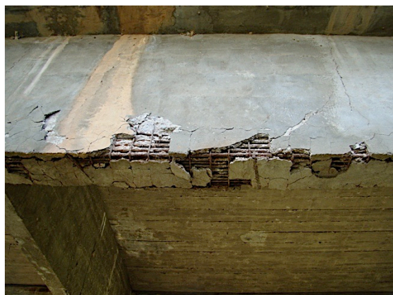
Figura 15: falha de concretagem ( F_i = 4 )
