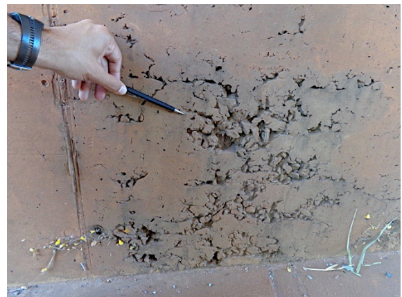
Figura 12: falha de concretagem ( F_i = 2 )
