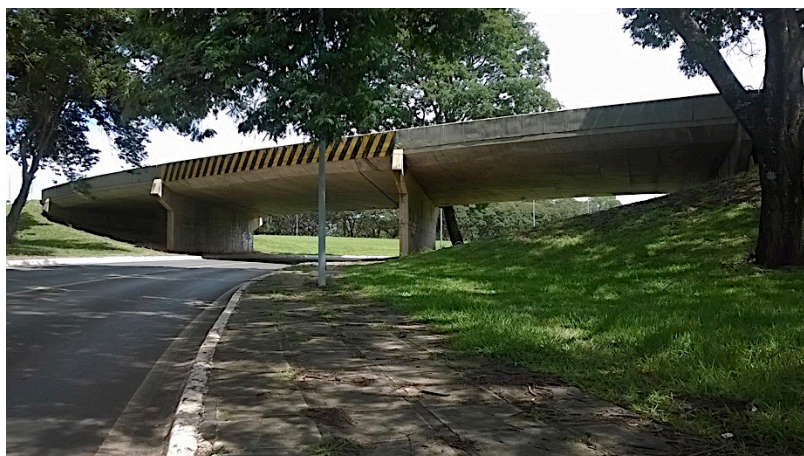
Figura 6.25 - Vista lateral da OAE-17, superestrutura em laje de concreto apoiada diretamente em pilares parede.
