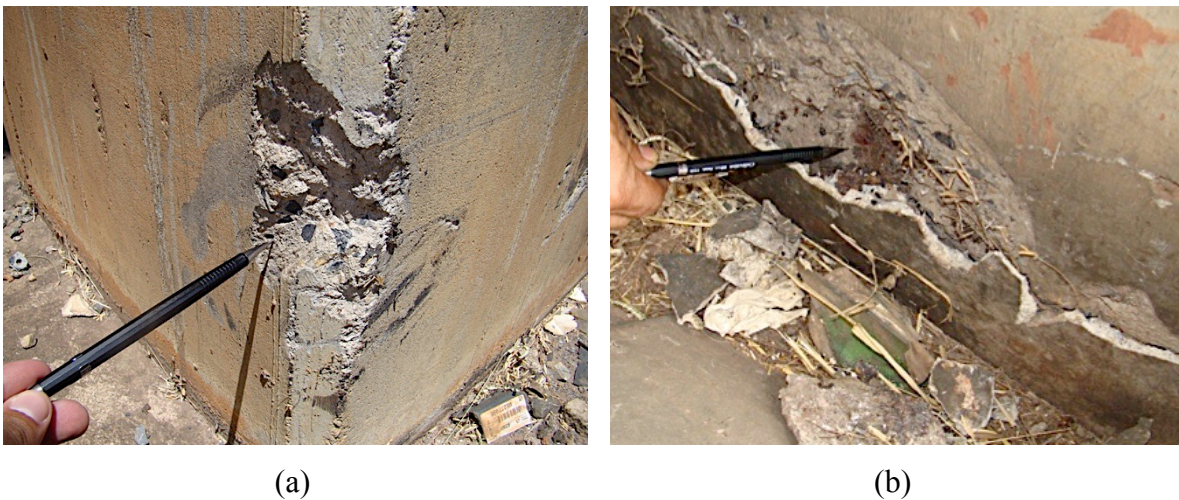
Figura 7.2 - Danos encontrados nos pilares da OAE-05: (a) deslocamento no pilar P8 sem a exposição da armadura, e (b) corrosão de barra longitudinal do pilar e deslocamento do concreto do pilar P10.
