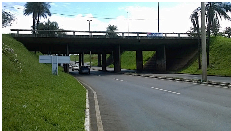
Figura 6.20 - Vista lateral da OAE-12, superestrutura em laje apoiada diretamente sobre pilares parede.
