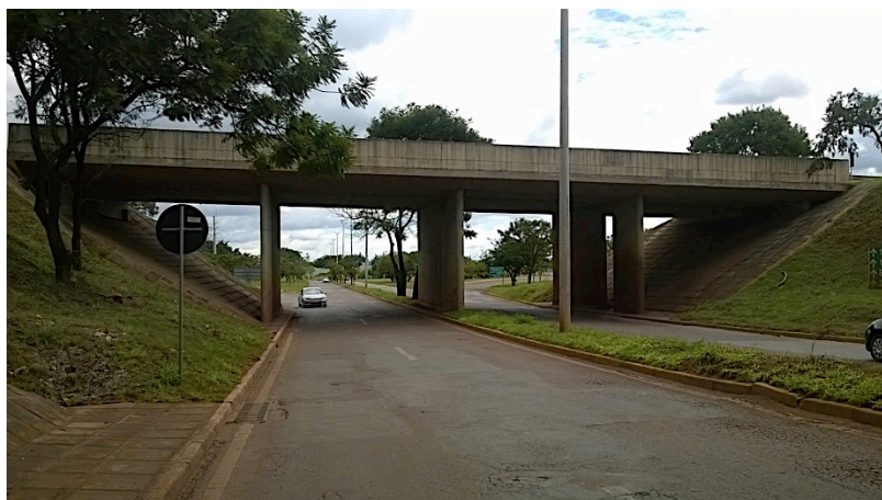
Figura 6.16 - Vista lateral da OAE-08, superestrutura em laje apoiada diretamente sobre pilares parede.
