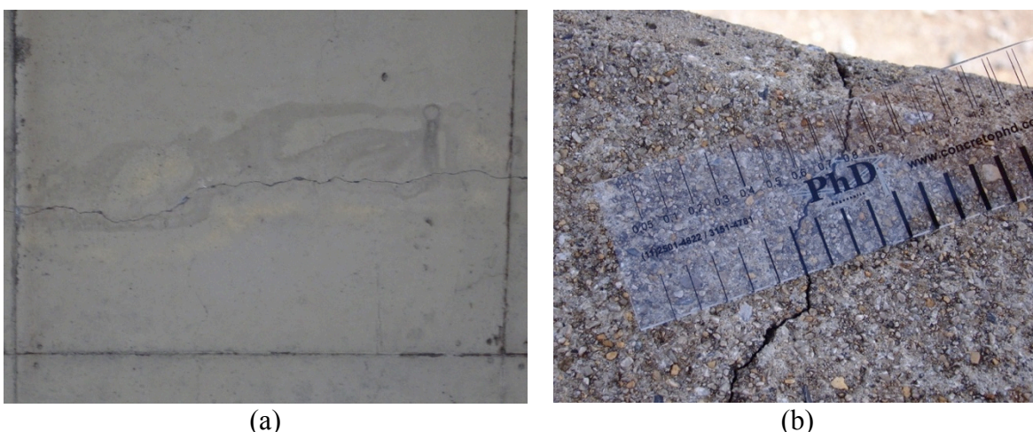
Figura 6.5 - Danos detectados na laje e na barreira da OAE-01. (a) Fissura na laje; (b) Fissura na barreira New Jersey.
