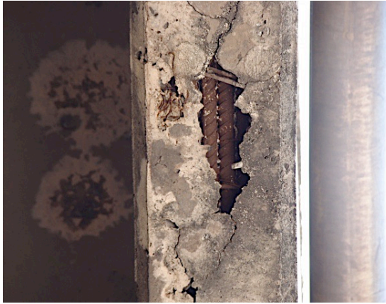
Figura 1: corrosão de armadura ( F_i = 2 )
