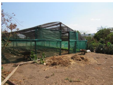
Figura 5 - Estufa construída no PME (área externa).
