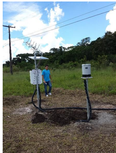
Figura 38: Instalação estação pluviométrica e fluviométrica - córrego Capetinga.
