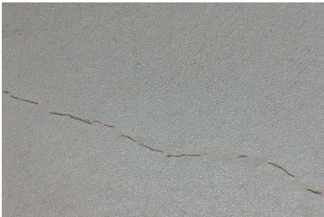
Figura 2.12 - Fissura em camada de revestimento impermeabilizante a base de Poliuréia em laje de trânsito de veículos. (Vasconcelos, 2012)
