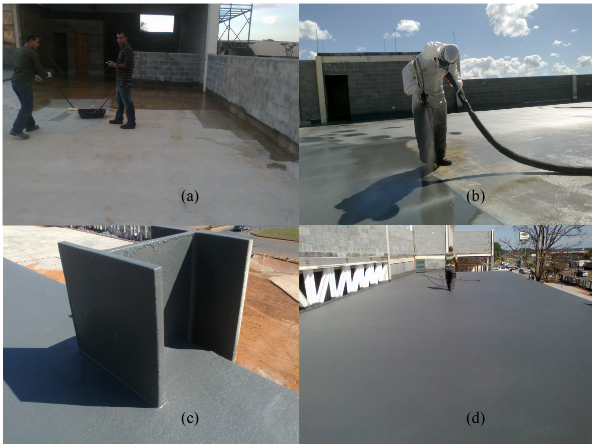
Figura 2.11 - Aplicação de Membrana de Poliuréia: (a) Aplicação de Primer Base epóxi - (b) Aplicação técnica “hot-spray” – (c) Detalhe pilar metálico aonde seria impossível a impermeabilização com sistemas tradicionais – (d) Resultado final de membrana aplicada. (Vasconcelos et. al. 2012)
