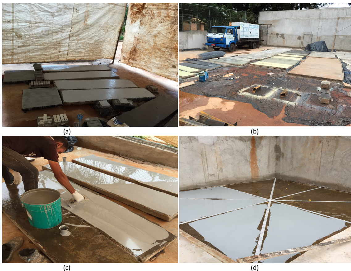
Figura 3.4 - (a) Corpos de prova recebendo aplicação dos sistemas impermeabilizantes, (b) Vista geral das lajes que receberam a aplicação dos sistemas impermeabilizantes, (c) Lajes de concreto armado recebendo as membranas do programa experimental, (d) Piso de concreto recendo os sistemas que serão submetidos ao teste de abrasão por pneus.
