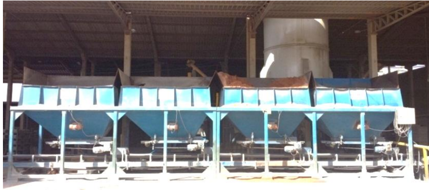
Figura 3.25 - Silos graneleiros utilizados para efetuar a dosagem dos materiais constituintes do traço.
