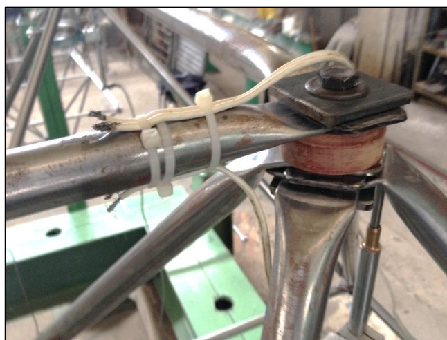
Figura 4.25 - Posição dos extensômetros eletrônicos perto do nó 6 (segundo ensaio)
