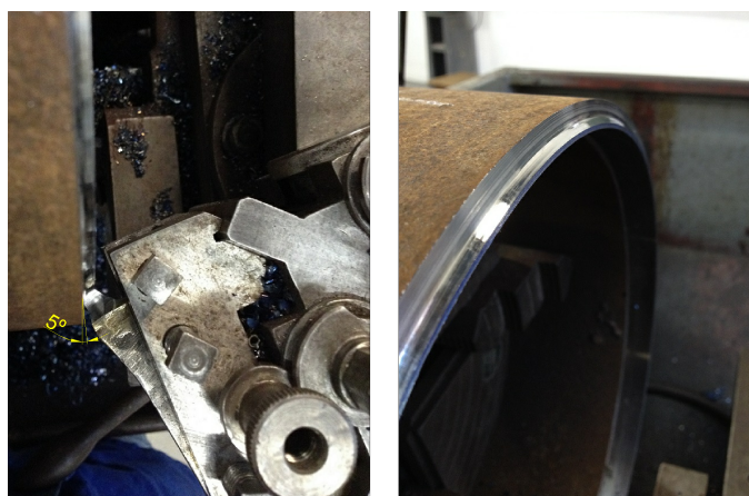
Figura 3.16. Posição da ferramenta no ponto final da construção do formato da junta no tubo.
