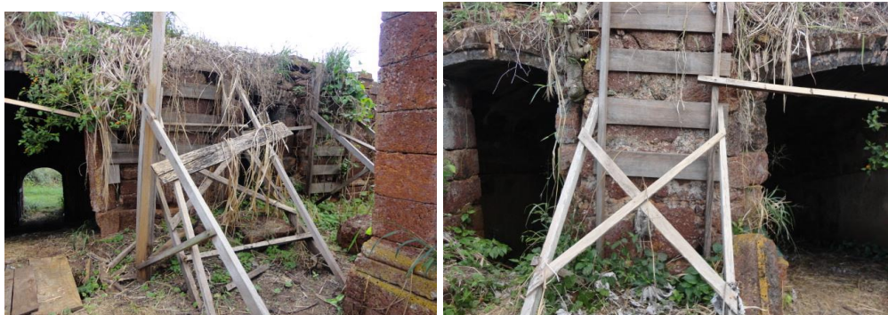
Figura 154 e 155: Paredes da entrada lateral escoradas
