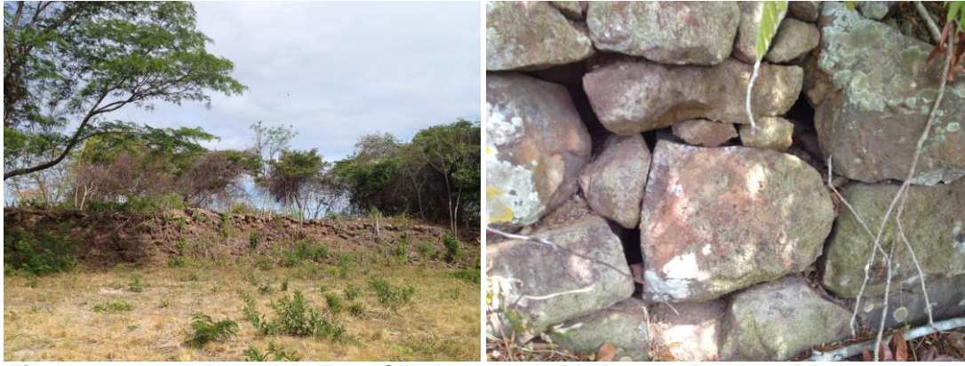
Figura 128 e 129: Lateral do Forte São Joaquim do Rio Branco, Roraima, RR, com detalhe construtivo. Fonte: Graciete Guerra da Costa, março, 2015.
