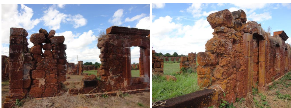
Figura 156 e 157: Paredes com pedras completamente soltas.
