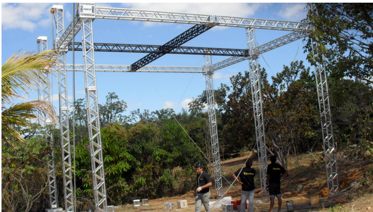
Imagem 52: Estrutura de Box Truss do espetáculo “O Homem Cadente”, montada em uma chácara em Brasília para a realização dos ensaios e da estreia. Foto: Diego Borges, 2012.
