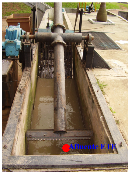
Figura 4.2 - Tratamento preliminar e ponto de coleta - afluente ETE.
