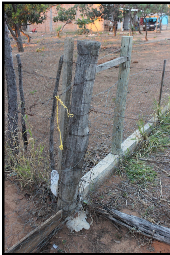
Figura 4-11 – Nó do circuito-cerca onde se via 4 derivações formando diversas malhas.
