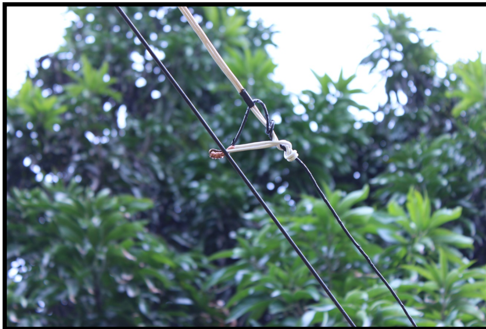
Figura 4-6 – Detalhe das emendas recentes e desprotegidas em uma das derivações da rede de distribuição de energia elétrica da fazenda.
