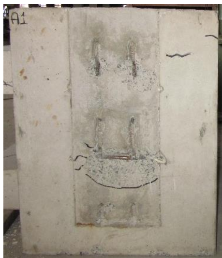
(b) Laje após destacamento.
