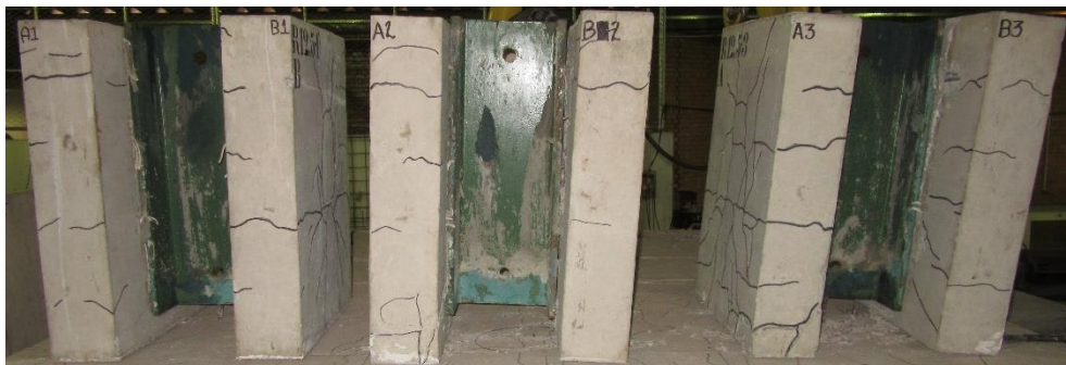
(a) Lateral das lajes A e B.
