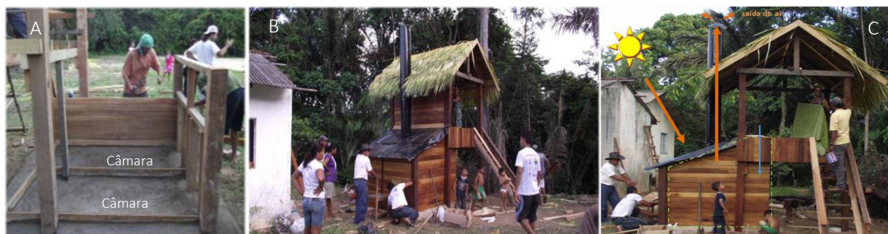
Figura 4 – A construção do banheiro seco: desde a construção das câmaras de armazenagem (A) até a pintura dos metais destinados ao fechamento das câmaras e ao respiro (B), e sua forma de ação na decomposição do material fecal e na eliminação dos parasitos (C). Projeto da bioarquiteta Patrícia Latuf Marba
