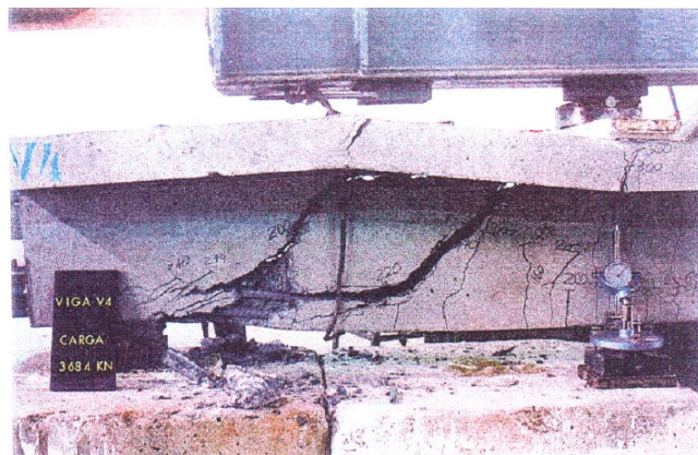
(b) Fissura principal de falha por cortante. Salles (2000)
