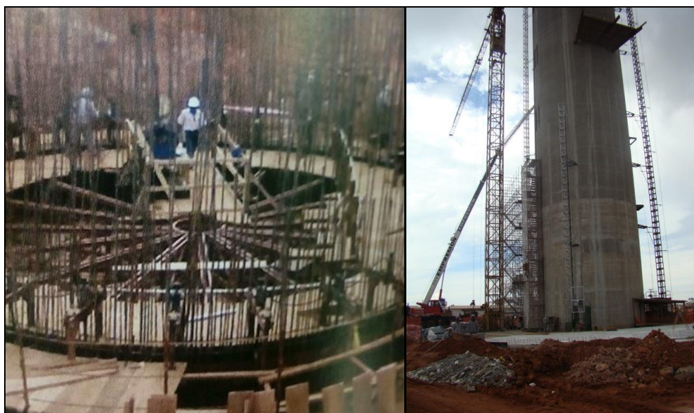
Figura 38 - Erguimento da armadura do fuste da base em concreto e aço - (ArPDF)
