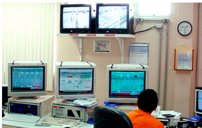
Figura 1.5 – Sala de controle do poliduto e de abastecimento no Tesol
