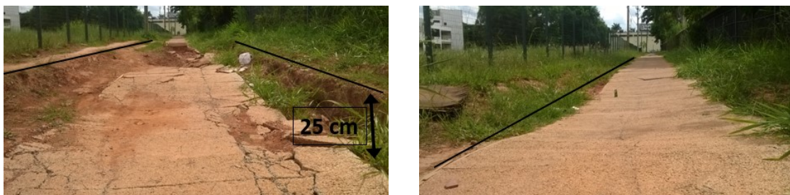
Figura 2.18. Desníveis e craqueamento, produto do colapso do solo por infiltração de água (Foto: Raimundo, 2016).
