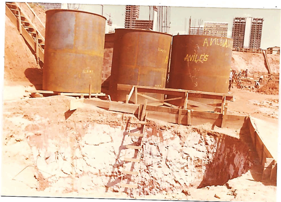
Foto nº 04 - As Camisas Especiais de Aço, já na Borda do Tubulão T-9 D ( I ), Vendo-se o Desmoronamento Que o Mesmo Sofreu
