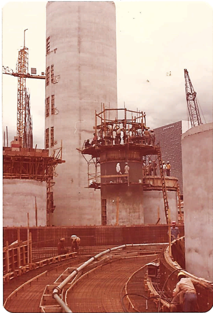
Vista da Rampa Circular em Fase de Limpeza, Destacando Também a Concretagem da Torre de Resfriamento Nº 1
