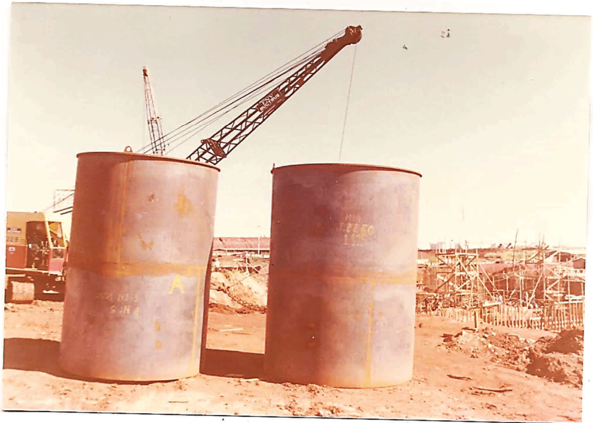
Foto nº 03 - Camisas Especiais de Aço Confeccionadas Para Permitir a Execução do Tubulão T-9 D ( I )
