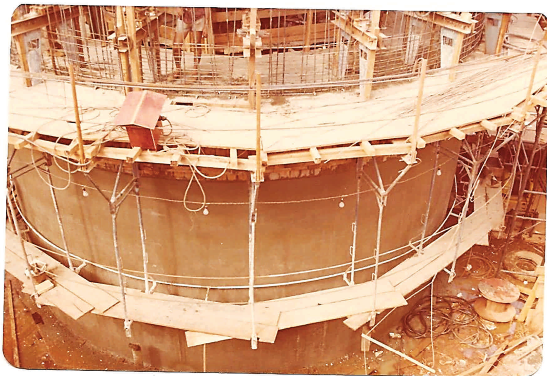
Foto 6 - Edifício-Sede - Torre 9 - Detalhe da Concretagem com Forma Deslizante, Estando o Trecho Concretado, com o Acabamento já Concluído
