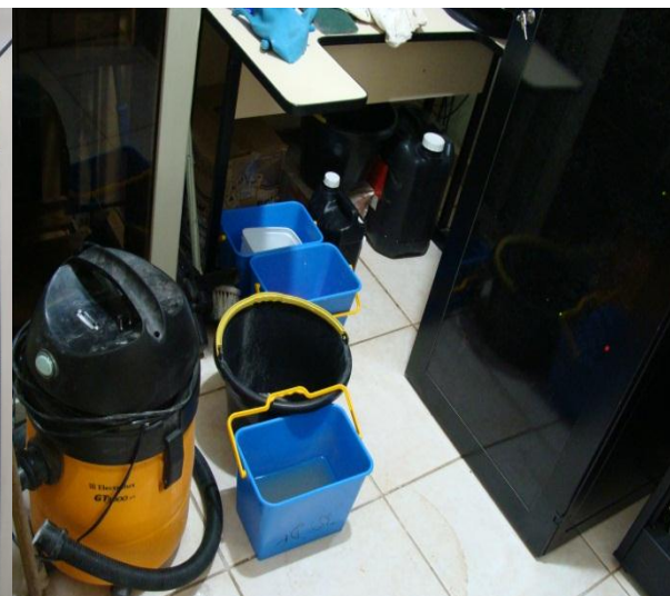
Figura 18 - 35ª DP – Sobradinho II (repare na sala de rede com goteiras e vazamentos)
